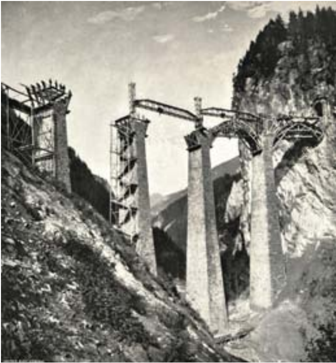
Landwasserviadukt > Die Eisentürme, welche die Brückenkrane tragen, sind in die Pfeiler eingemauert. Dadurch konnte auf die Erstellung von Gerüsten im hochwassergefährdeten Bereich verzichtet werden. Rhätische Bahn
