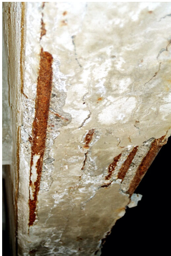
Bild 1: Beschädigter Brückenträger und Armierungseisen vor der Instandsetzung
