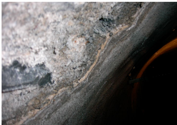
Betonkorrosion an Spritzbetonschale
